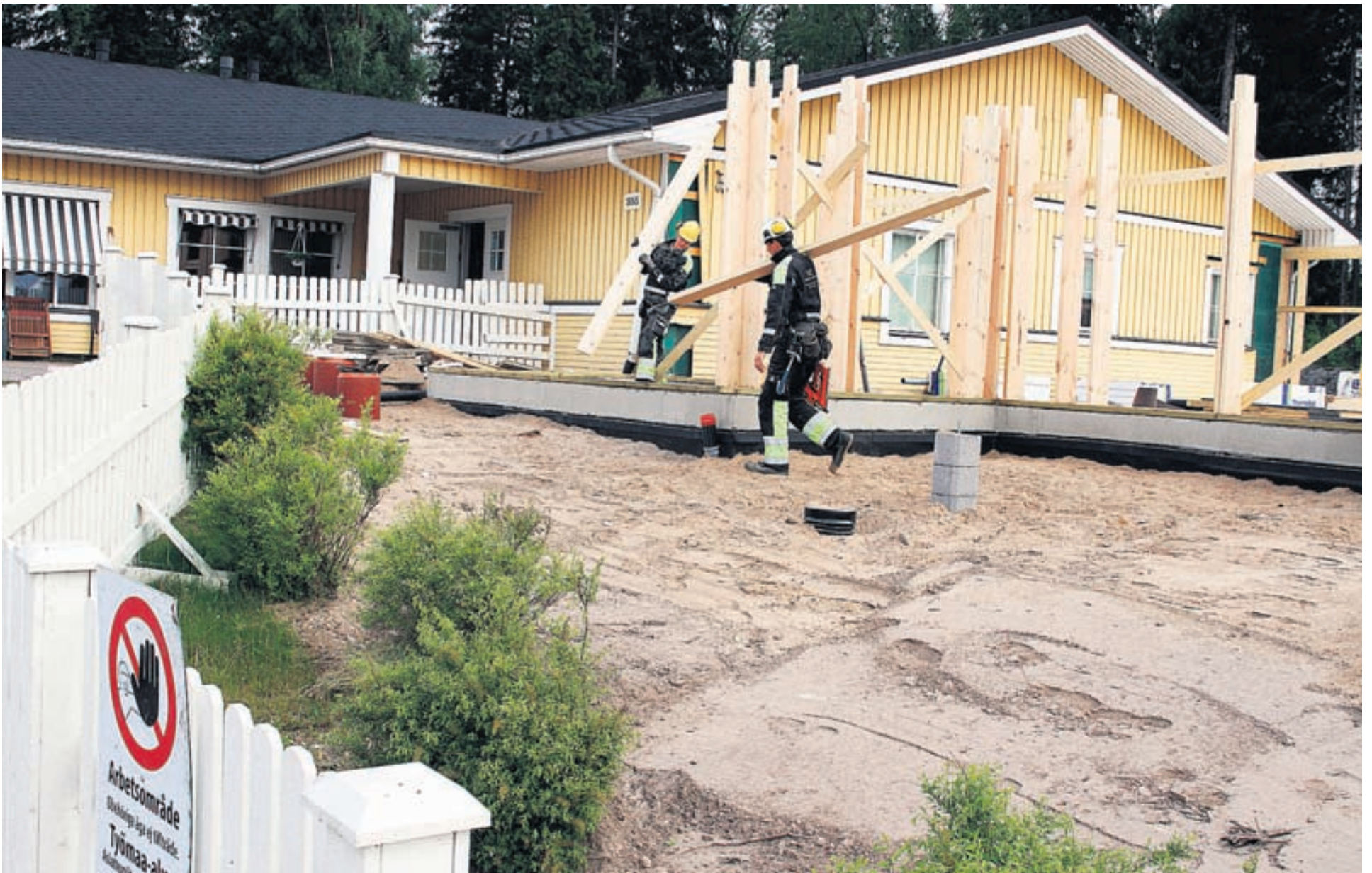
Dagistillbyggnaden går snabbt framåt. I måndags spirade byggjobbarna upp väggarna och inväntade takstolarna.
